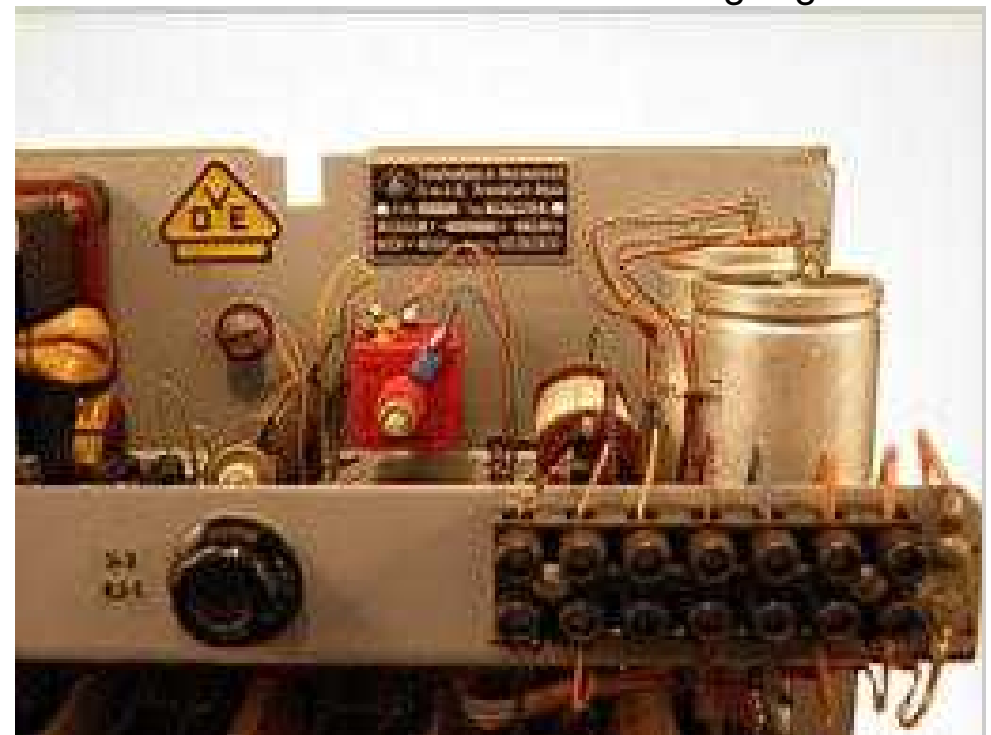
Klemmleiste der Stromversorgung
