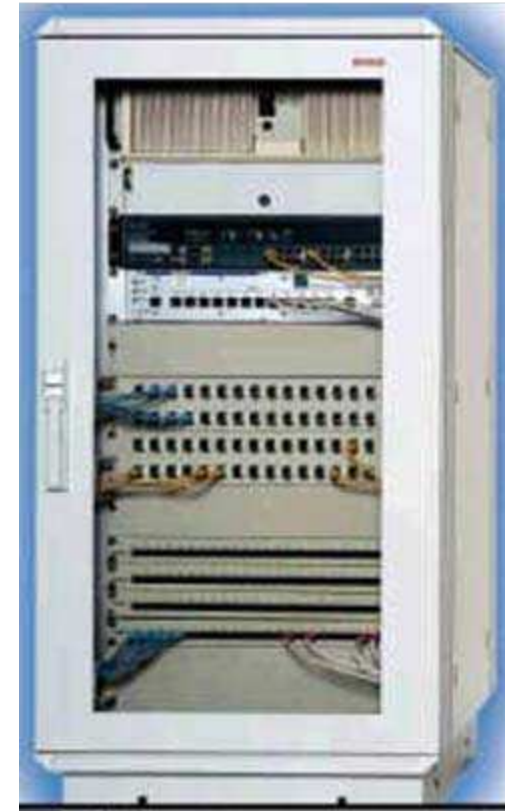
ISDN-Kommunikationssystem „Integral Communication Center“ für max. 148 Arbeitsplätze: • Kommunikationssystem • Applikationsserver (Accounting, ACD, VMS, UMS, IVR) • Integriertes Patch panell
