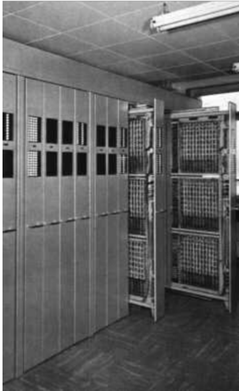
Nebenstellenanlage III W 6010 > 10 Amts- leitungen und 100 Neben- stellen
