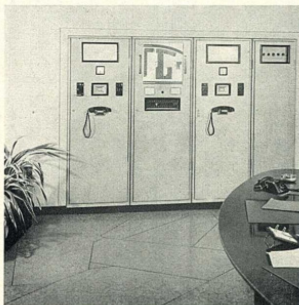
Melde- und Empfangseinrichtung für 2 kombinierte Feuermelde- und Wächterkontrollschleifen mit 2 Lageplatableaus und Überwachungszentrale für die Polizei-Notruf-Anlage
