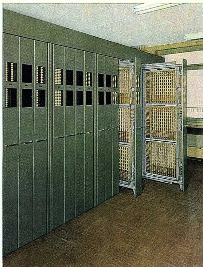
BILD 4 TN-Universal-Zentrale der Baustufe III W mit Flachschutzkontakten im Sprechweg
