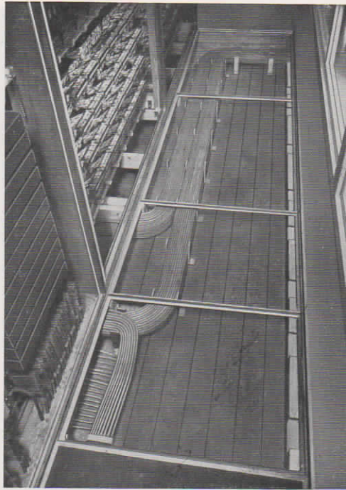
Abb. 9. Kabelführung im Podium im Rathaus Frankfurt a.M.
