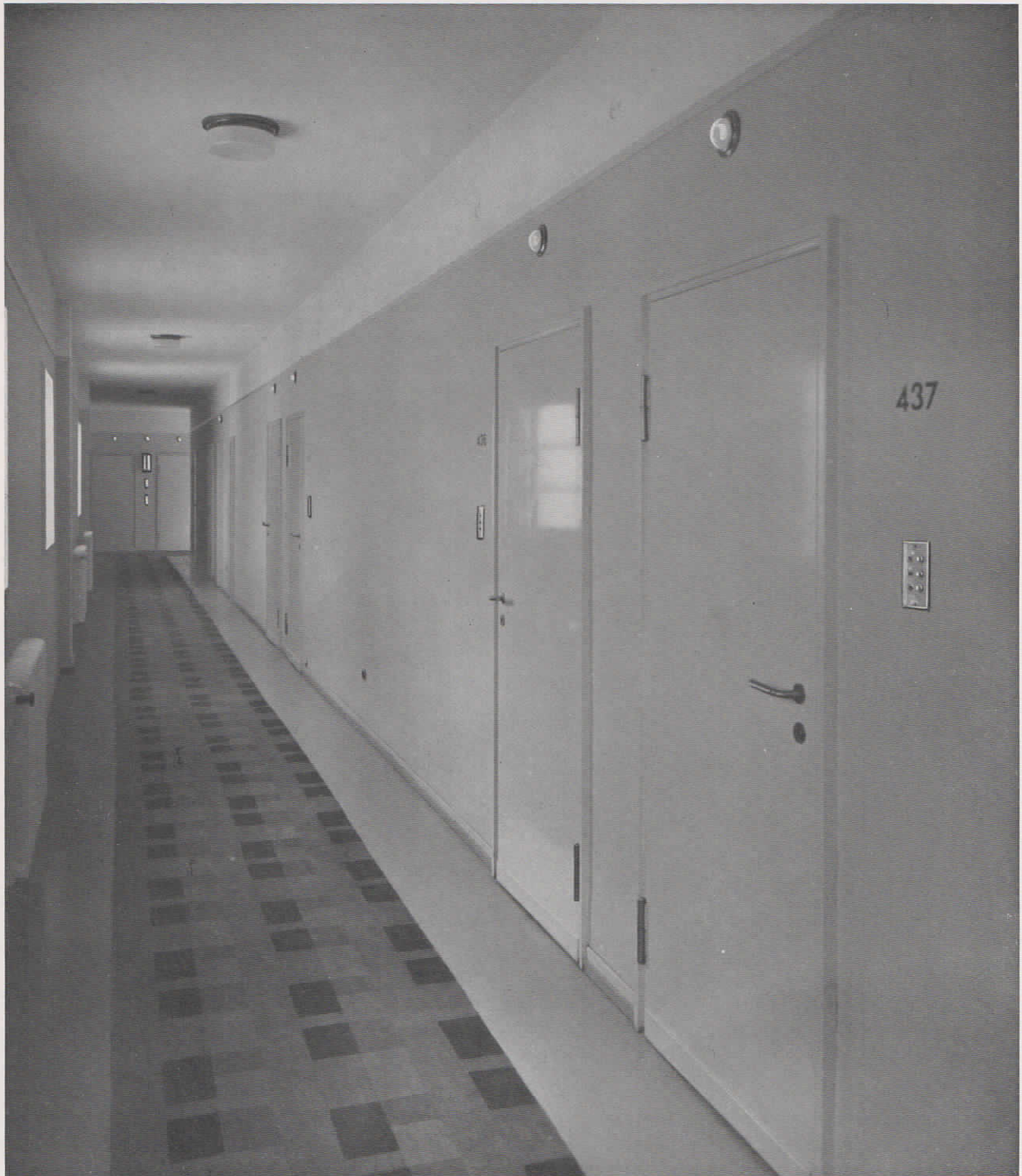
Abb. 3. Flur mit Zimmer- und Richtungslampen, sowie Abstelltaster für die Lichtrufanlage im Palast-Hotel Mannheimer Hof, Mannheim
