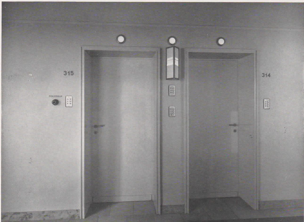
Abb. 4. Flur mit Zimmer- und Richtungslampen, Abstelltaster und Einschalttaster für Kellner, Mädchen, Diener im Palast-Hotel Mannheimer Hof, Mannheim
