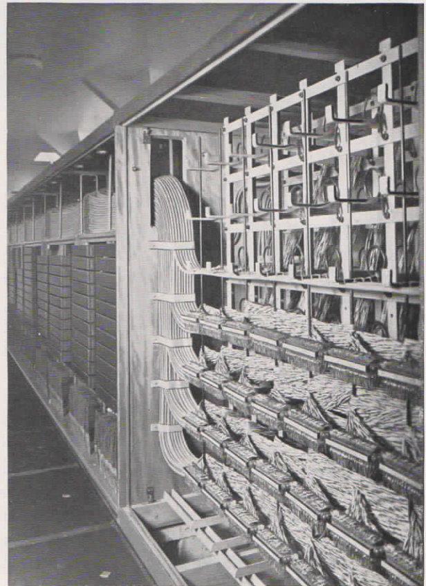
Abb. 8. Zwischenverteiler mit Vielfachverkabelung in den Bedienungsschränken, im Rathaus Frankfurt a. M.
