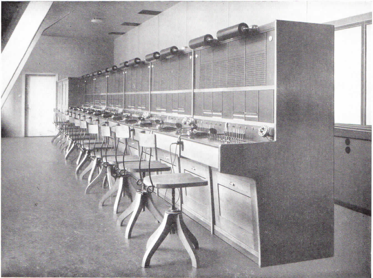
Abb. 3. Halbautomatische Nebenstellen-Zentrale. Vermittlungsplätze für den ankommenden Verkehr, von den Ortsplätzen aus gesehen, im Rathaus Frankfurt a. M.
