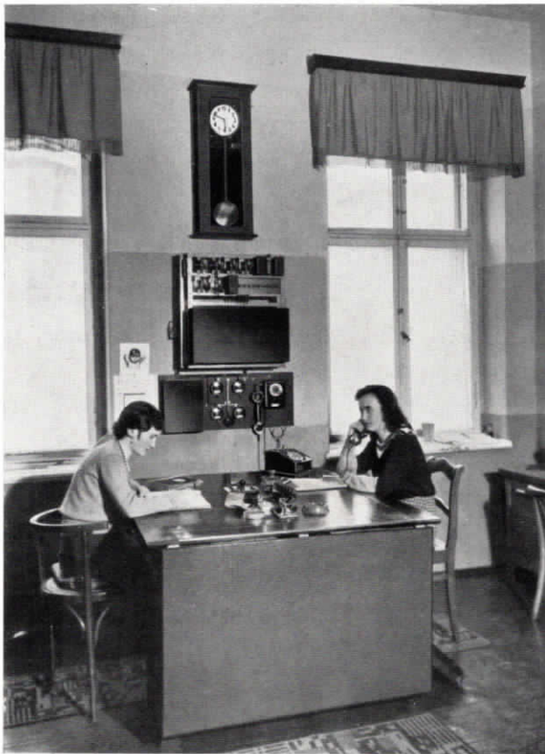
Abb. 55. Fuld-Universal-Fernsprechanlage (S.A.-Nebenstellen-Anlage) im Central-Theater in Bautzen
