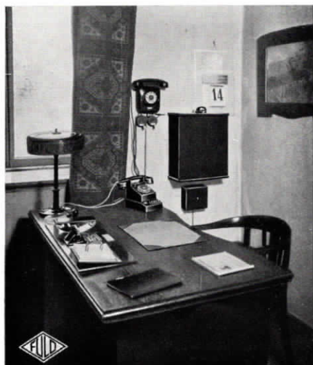
Abb. 30. Abfragestelle einer Fuld-Kleinfernsprech-Anlage (H. V. S.) in der Privaten Kraft-fahrschule Erich Mater Dresden
