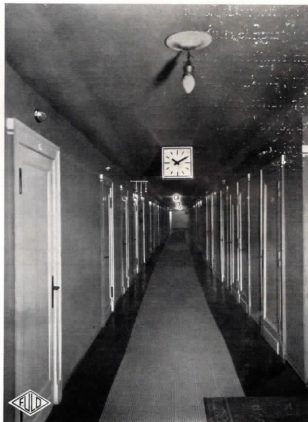
Abb. 16. Flur im Park-Hotel in Leipzig mit Fuld-Lichtsignalapparaturen (Zimmerlampen über den Türen u. Signalarmatur) und doppelseitiger transparenter Normalzeit-Nebenuhr
