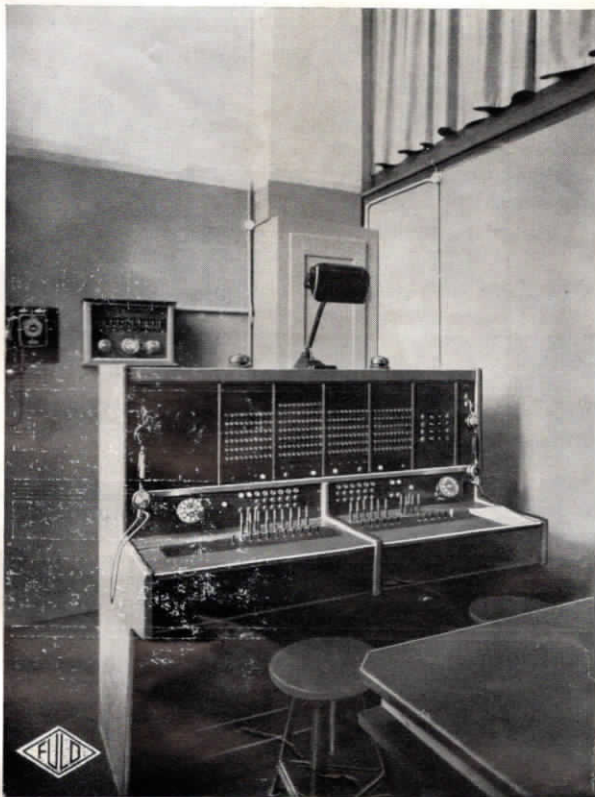
Abb. 2. Fuld-Fernsprech-Glühlampenzentrale für 12 Amtsleitungen und 230 Nebenstellen (dem internen Verkehr dient eine vollautomatische Fuld-Fernsprechzentrale für 25 Teilnehmer) im Hotel Astoria in Leipzig
