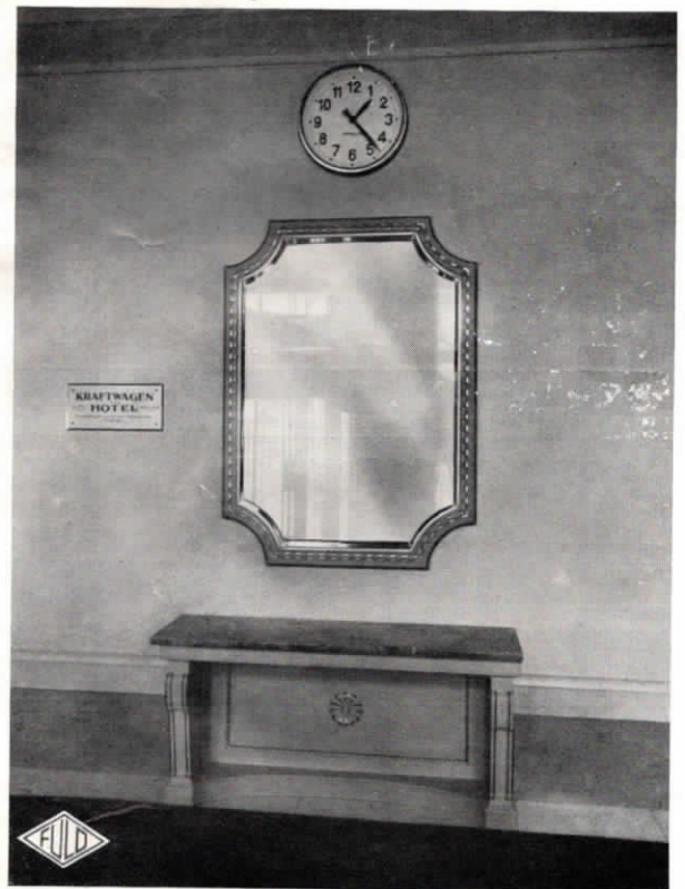
Abb. 3. In die Wand eingelassene elektrische Normalzeit-Nebenuhr auf einem Flur im Hotel Astoria in Leipzig. Die Normalzeit-Uhrenanlage besteht aus einer Hauptuhr und 12 Nebenuhren
