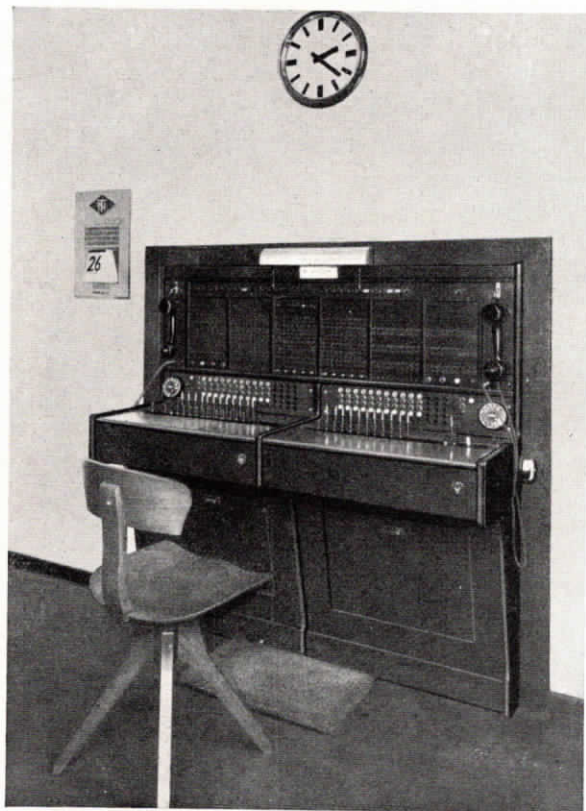
Abb. 2. Abfrageplätze für den ankommenden Amtsverkehr im Regierungsdienstgebäude Oppeln O.-S.
