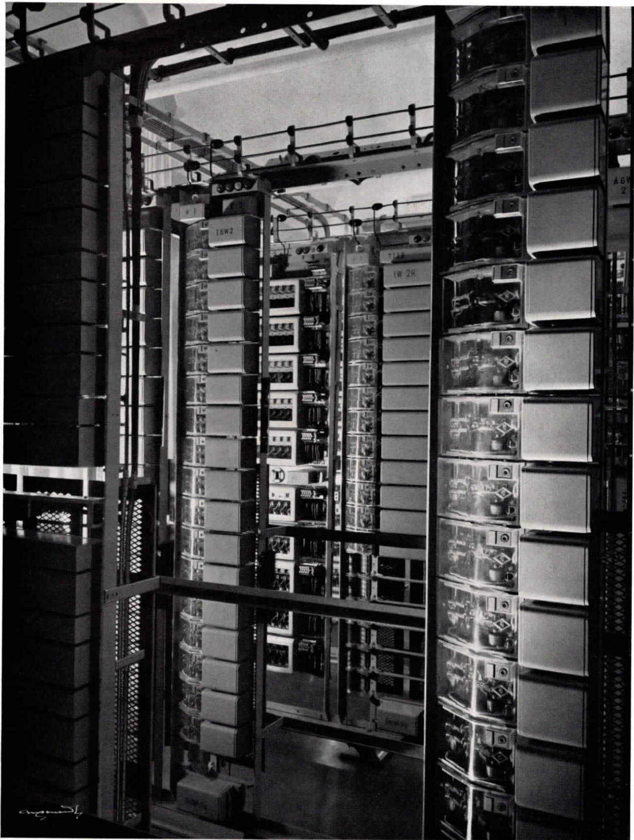
Abb. 5 Einen Blick auf die Wählergestelle
