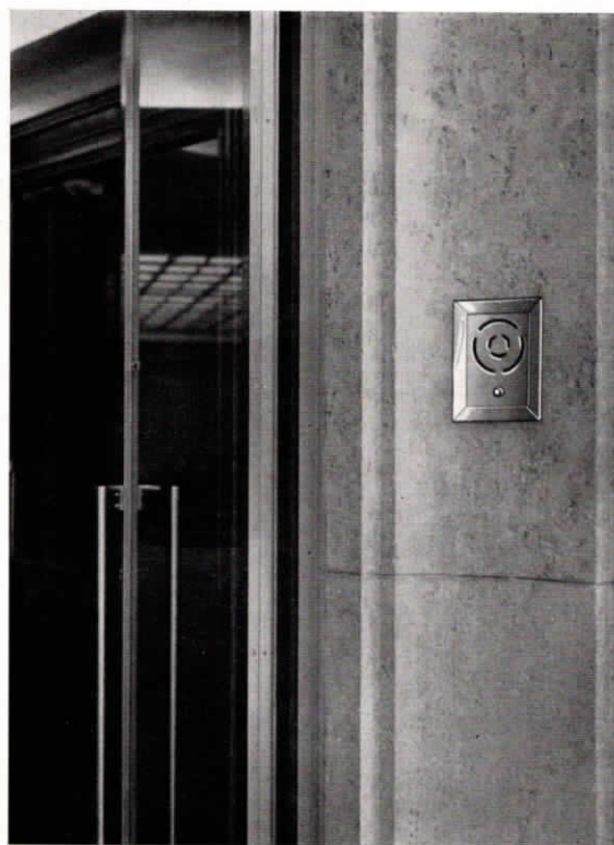
Abb. 13 Türlautsprecher zur Pförtnerloge
