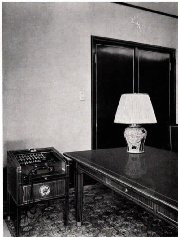
Abb. 6 Blick in ein Direktionszimmer mit fahrbarem Spezial-Telefonapparat für die Direktions-Fernsprechanlage und Normalzeit-Nebenuhr über der Türe
