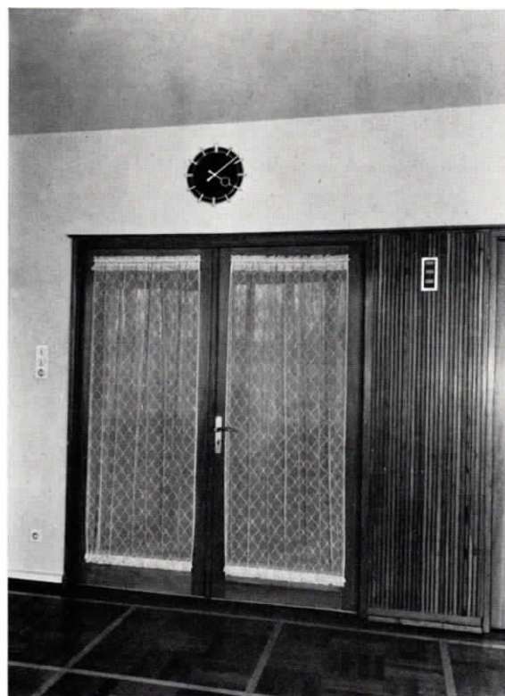
Abb. 7 Eingebaute TuN-Nebenuhr und Personensuchtablo
