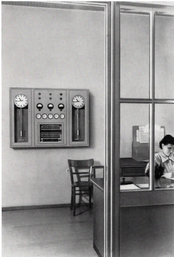
Abb. 11 Uhrenzentrale im Befehlsstellwerk, die sämtliche Nebenuhren auf dem Bahnhofsgelände steuert
