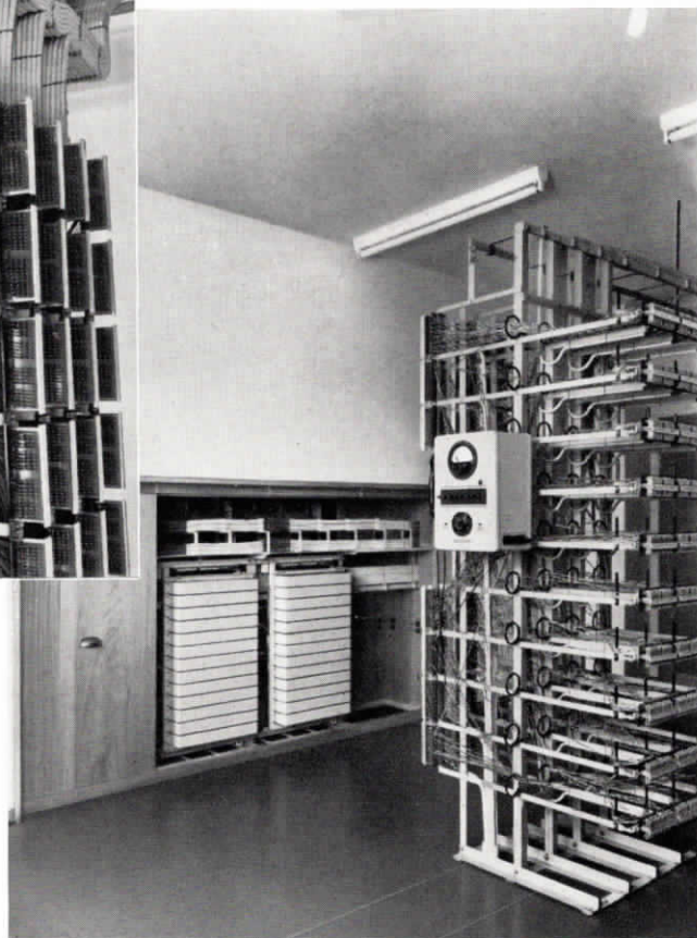
Abb. 11 Hauptverteilteraum mit VH und Rückansicht der zweiplätzigen Vermittlungs-Einrichtung bei Vorwerk & Co, Wuppertal-Barmen
