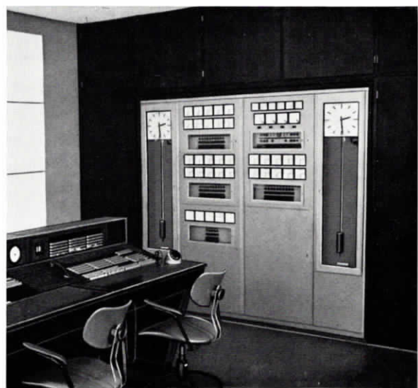
BILD 12 Uhrenzentrale mit zwei Hauptuhren
